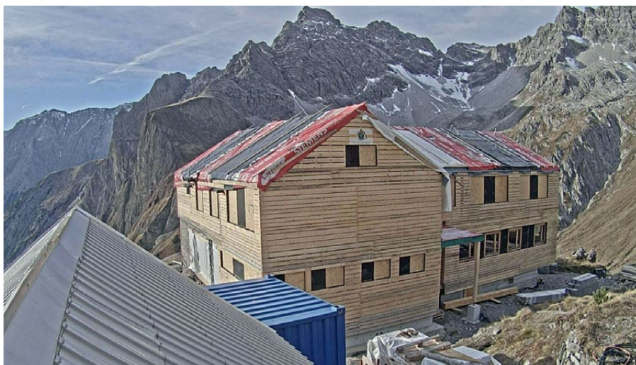
Dank meist günstiger Witterung im Oktober konnte die Außenhülle noch vor dem Winter fertiggestellt werden.
